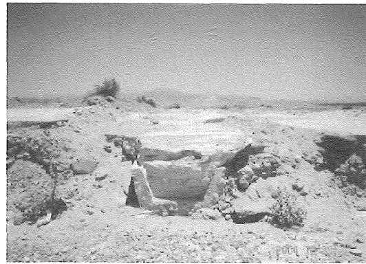
図 2-6 土石流で破壊された灌漑水路。 ナスカ市街の西方，ナスカ川北岸支流を横 切る灌漑水路。細砂層が堆積している。
