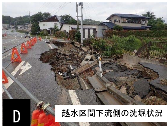
図 15. 道路面に越水した痕跡（手前はマンホール部の洗掘が顕著）
