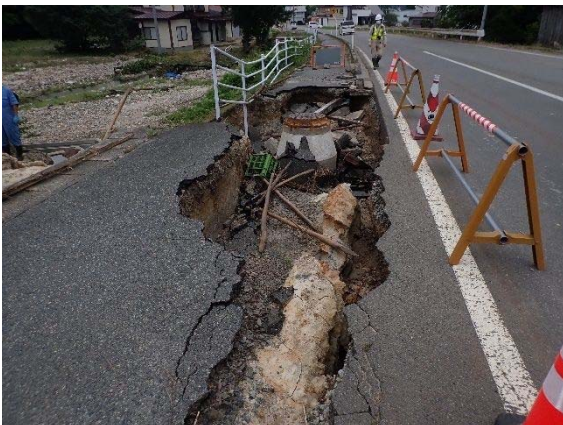
図 20. マンホール周辺の洗掘状況
