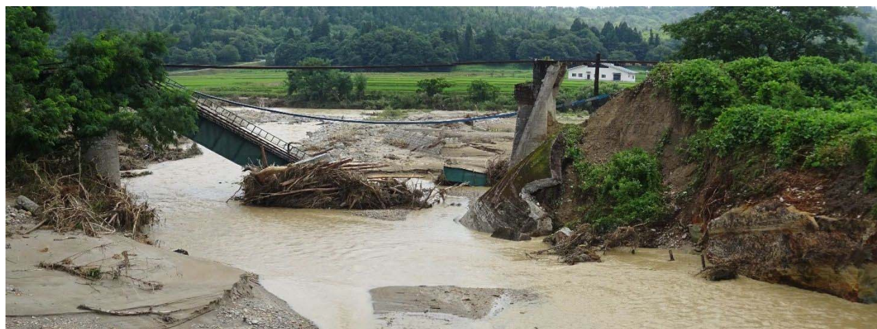
図 21. JR 米坂線、小白川橋梁倒壊箇所の状況（上流側より） ※蛇行区間となっており、攻撃斜面側（右岸側）は橋台部も大きく洗掘を受けている
