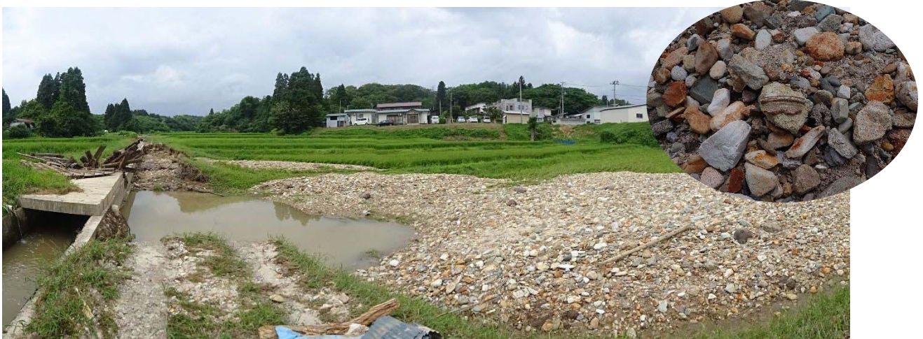
図 12. 水路沿いの越流箇所（拡大） ※水路にかかる蓋に流木が詰まり越水し，周囲の洗掘及び土砂堆積が発生
