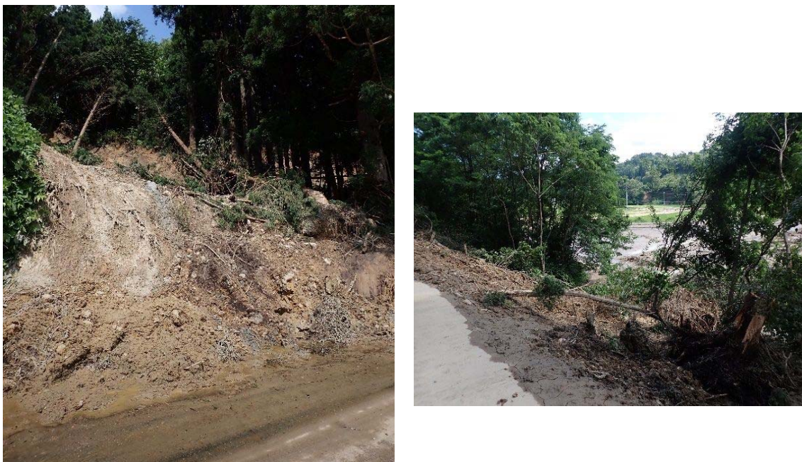
図 33. 土石流の痕跡が残る斜面（下流側） ※流水は僅かで、斜面中に倒木が残る
