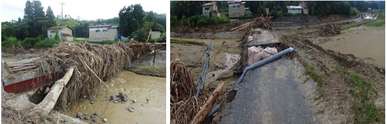
図 42. 対象橋梁の状況（多量の流木が残されており、左岸側は洗掘を受けている）
