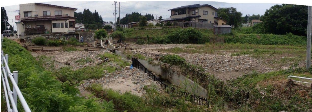
図 17. 下流側からの水路越流箇所 ※落差のある区間で土砂の堆積が認められる
