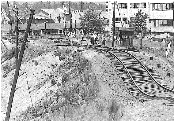
写真-11 越後線白山駅付近の鉄道路盤の変形
