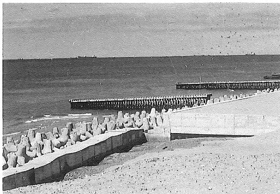
写真-1 津波で護岸堤の裏まで侵入した海水の跡
