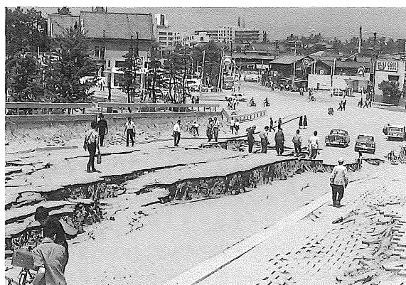
写真-9 昭和大橋西側取り付け道路の陥没
