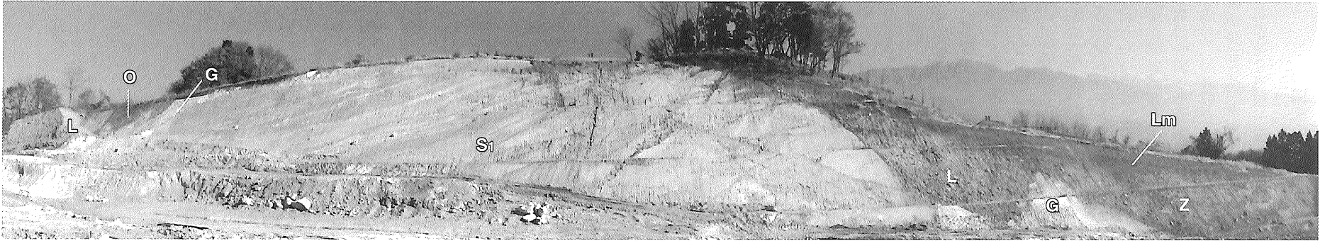
写真-2 「北東大露頭」東側法面の露頭中央部は浮石質凝灰岩（菅沢層下部，S 1 ）で現位置の基盤岩であるが、右側で「溶岩崩れ」（L）に覆われる部分はひび割れている。「溶岩崩れ」（L）は基盤岩や「グリーン崩れ」（G）をシャープに切って覆う。最上部の崩壊堆積物として「雑色凝灰角礫崩れ」（Z）が覆うが最下位の境界部は炭質物に富む泥炭質粘土などが夾まれていた。最上位は現地性のローム質土（Lm）が覆う。
